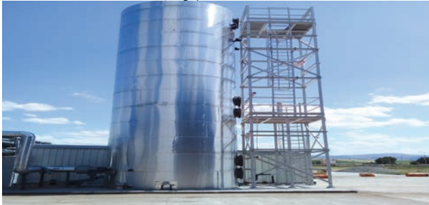
Resim 4. Desülfirizasyon Ünitesi(Şarkışla Biyogaz Tesisi,2021)
