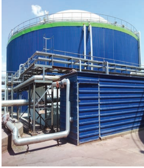
Resim 3. Fermantasyon Tankı (Reaktör)(Şarkışla Biyogaz Tesisi,2021)
