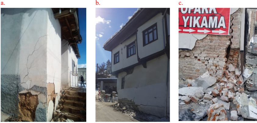
Şekil 15. Tabanda ezilmeye bağlı yapısal hasarlar
