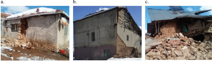
Şekil 17. Malzeme özelliklerine bağlı yapısal hasarlar
