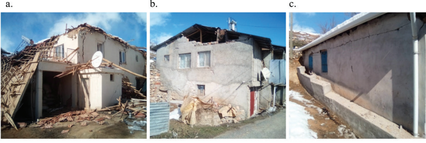
Şekil 25. Yetersiz çatı-duvar bağlantısına bağlı yapısal hasarlar
