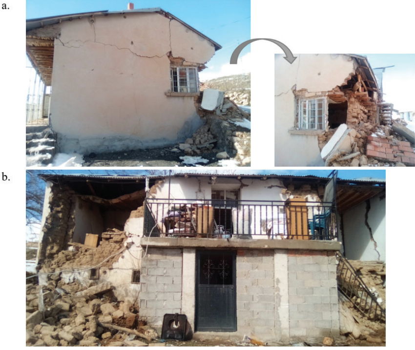
Şekil 16. Düzlem dışı davranışa bağlı yapısal hasarlar
