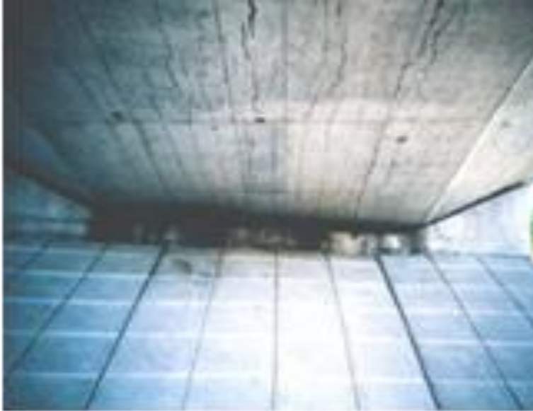
Şekil. 1 ASR'den etkilenen 20 yaşındaki otoyol köprü güvertede pervaz üzerine boyuna çatlama [5].
